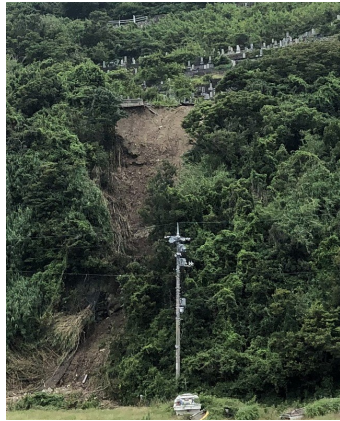
今年7月初めに、東のお墓の下の斜面でがけ崩れがあり、一番下の段のお墓も流された。
